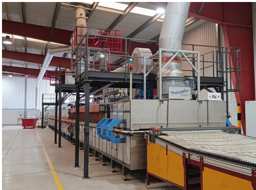
Figura 7. Horno eléctrico para la cocción de baldosas cerámicas instalado en la empresa Equipe Cerámicas 48 .
